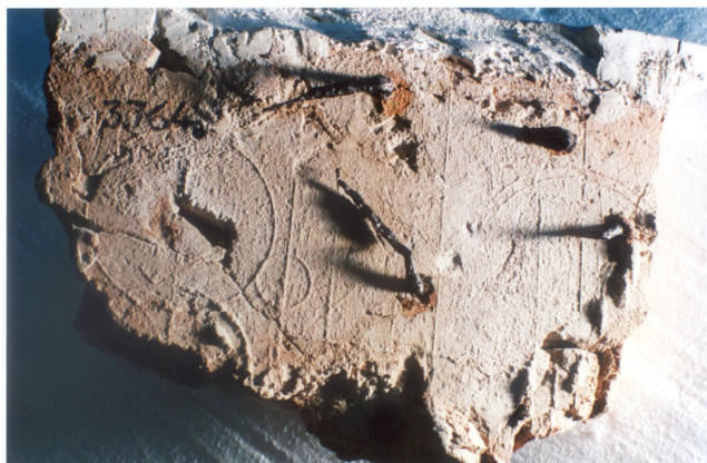
Figura 3. Detalle del sistema de fijación de clavos metalicos en el reverso de un capitel de yeso desprendido.
